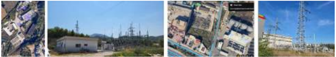
Nënstacioni Elektrik në Nj. A. Farkë “HENRY”
