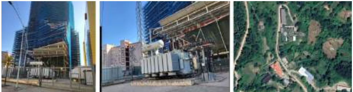
Nënstacioni elektrik Qendër administrim i OSSH Vogël
