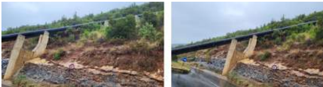
Fig. 228: Tubacione në kryqëzim me rrugën Tiranë – Shëngjergj në zonën e Dajtit, në të cilat transportohet uji i Selitës për HEC-Lanabregas, si dhe për Tiranën
